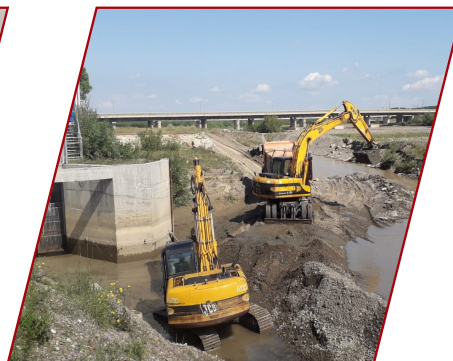
Asigurarea infrastructurii și mijloacelor necesare
