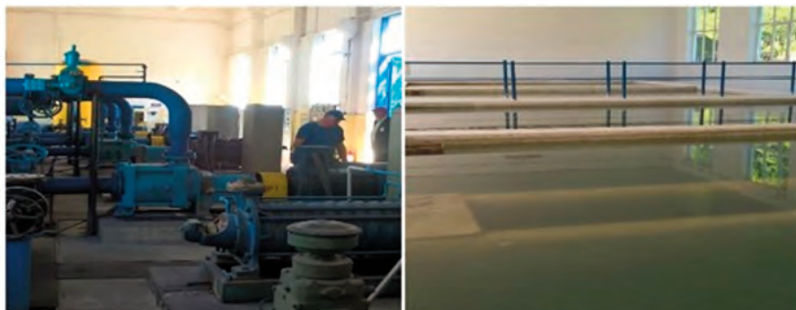
Stație de tratare apă - realizează tratarea apei brute preluată din sursele de suprafață și dezinfecția apei captată din izvoare sau prin foraje
