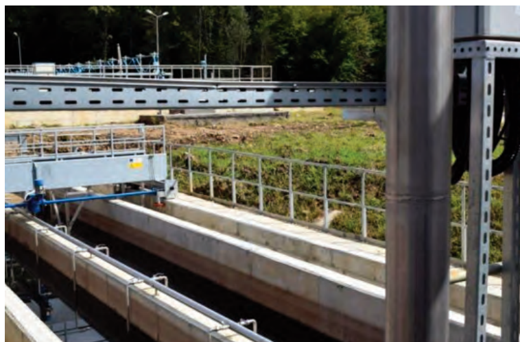
Stație de epurare - realizează tratarea apelor uzate cu treaptă mecanică și biologică
