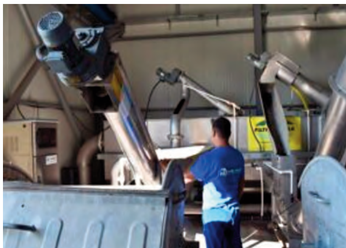
Stație de tratare a apei - realizează monitorizarea de control a apei potabile distribuită consumatorilor
