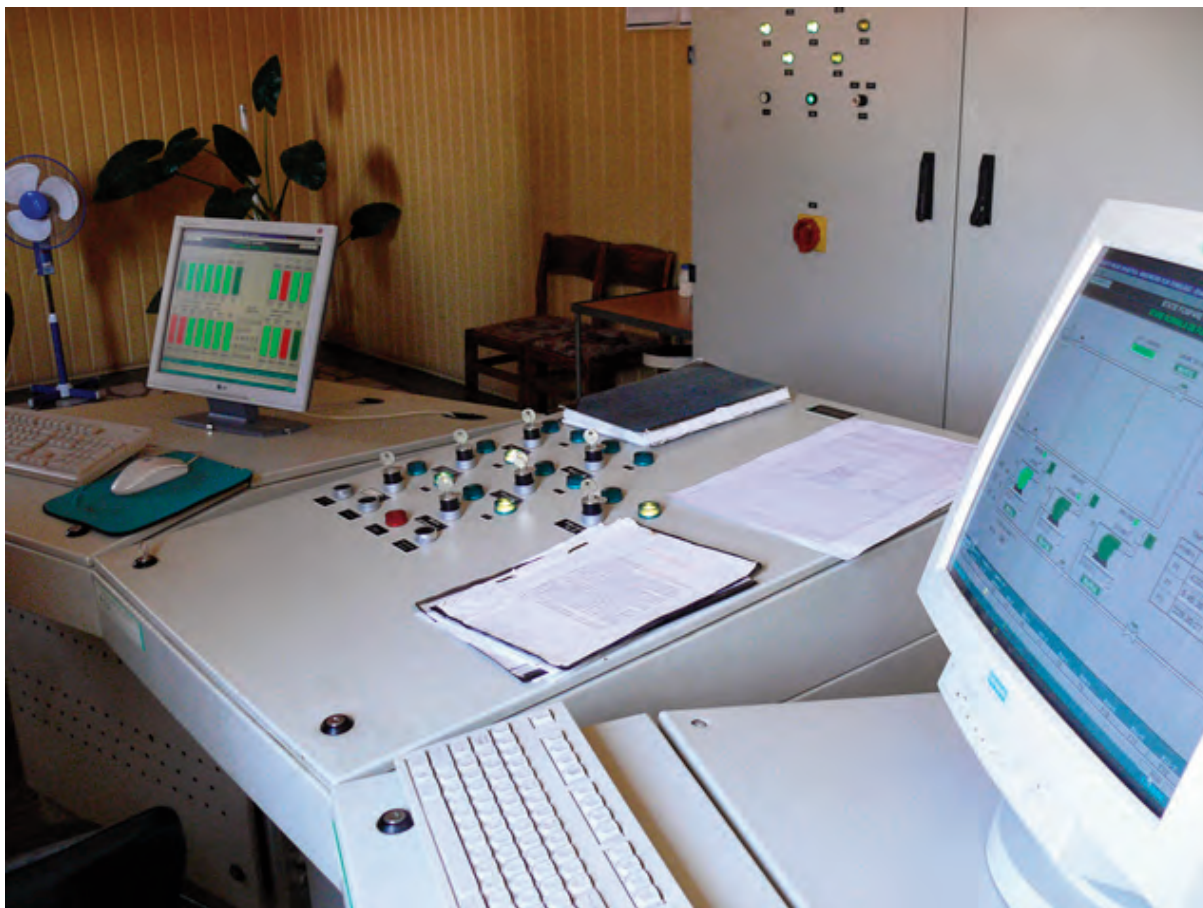
Fig. 6. Dispecerat - Stație Tratare Bistrița / Base - Bistrita Treatment Station
