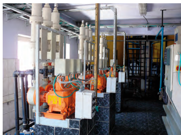
Fig. 5. Pompe dozare - Stație Tratare Bistrița / Dosing pumps - Bistrita Treatment Station
