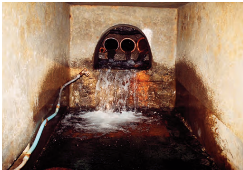
Fig. 1. Captare izvoare Olga, Frida și Hermina / Olga, Frida and Hermina springs catchment
