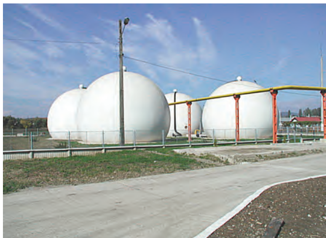
Fig. 9. Rezervoare biogaz - Stație epurare apă uzată Bistrița / Biogas tanks - Bistrita Wastewater Treatment Plant
