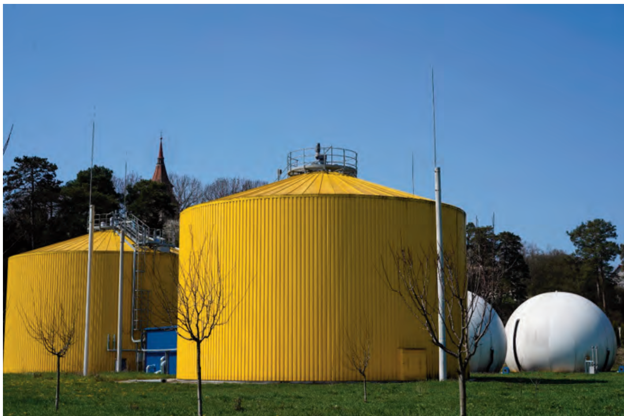
Fig. 2 - Gazometre - Stația de epurare Feldioara / Gas meters - Feldioara Wastewater Treatment Plant
